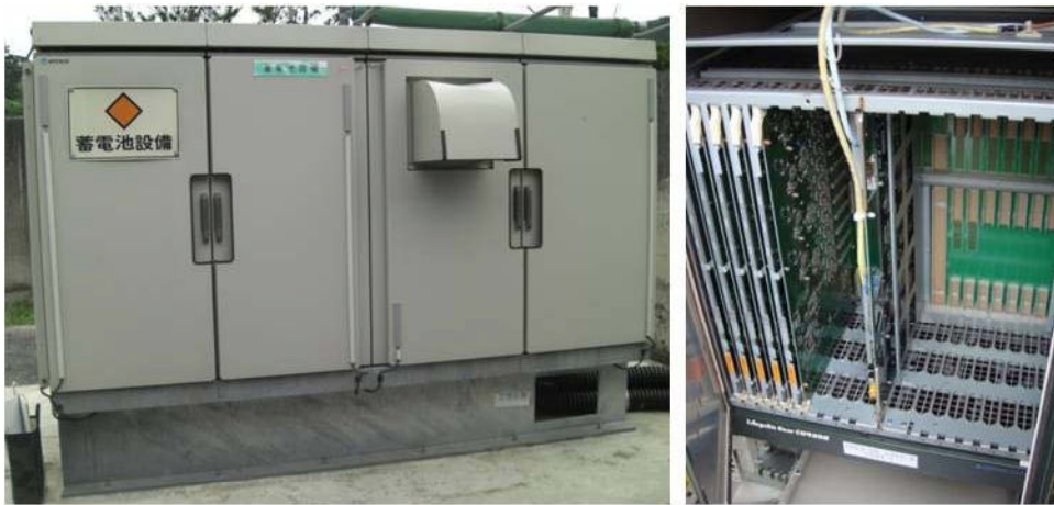
図 8-10 屋外収容ボックスの外観及び内部の通信装置
