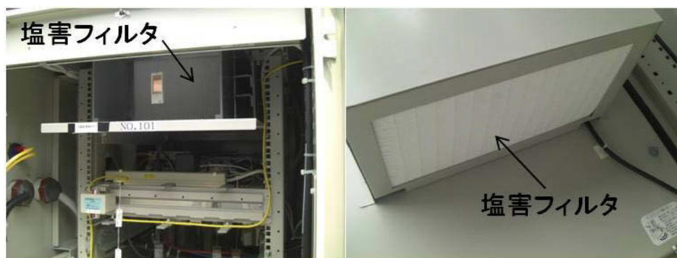
図 8-16 設置した塩害フィルタの写真
