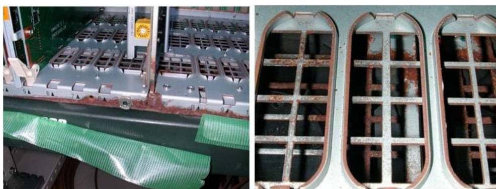
図 8-11 屋外収容ボックス内部の腐食状況
