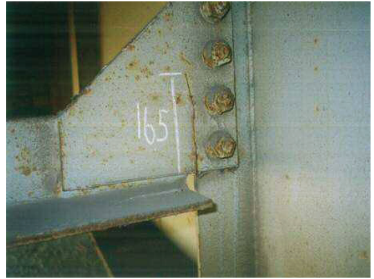
対傾構に発生したき裂
