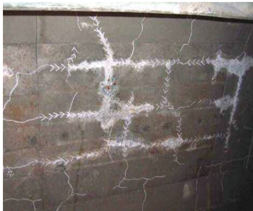
図-4.5.1 コンクリート床版の劣化事例
