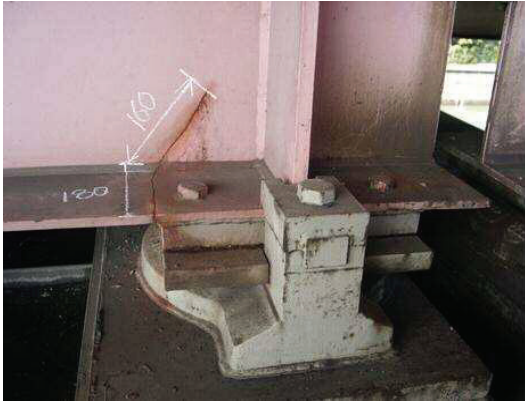
ソールプレートに発生したき裂
