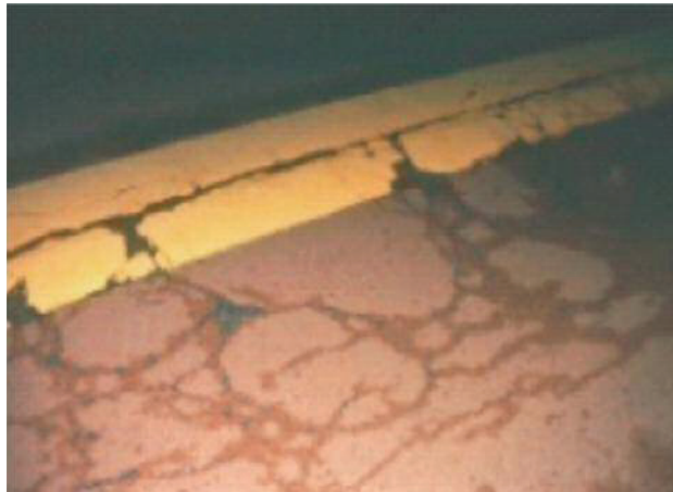
図-4.2.2 舗装のわだち掘れ
