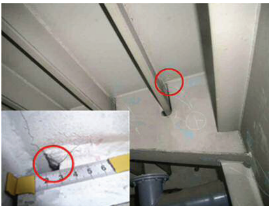
鋼床版と横リブ溶接部のき裂
