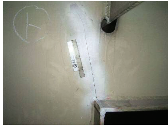
箱桁ダイヤフラムに発生したき裂
