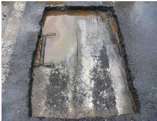
鋼床版上面に発生したき裂
