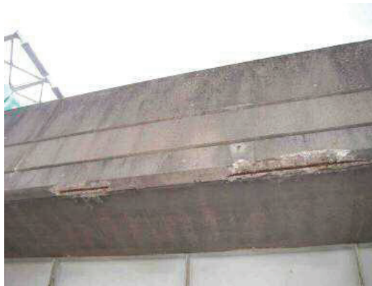
はく離・鉄筋露出
