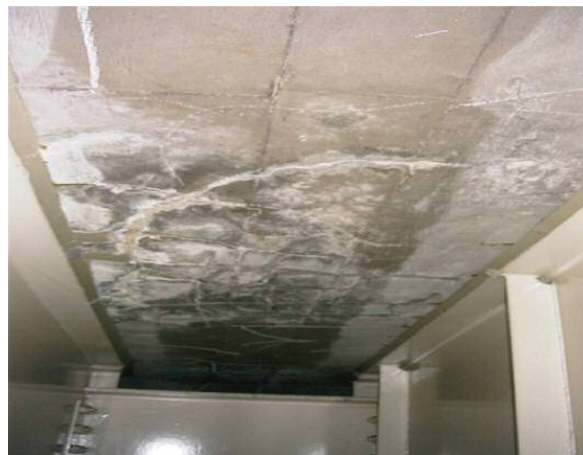
図-4.4.1 コンクリート床版の劣化事例
