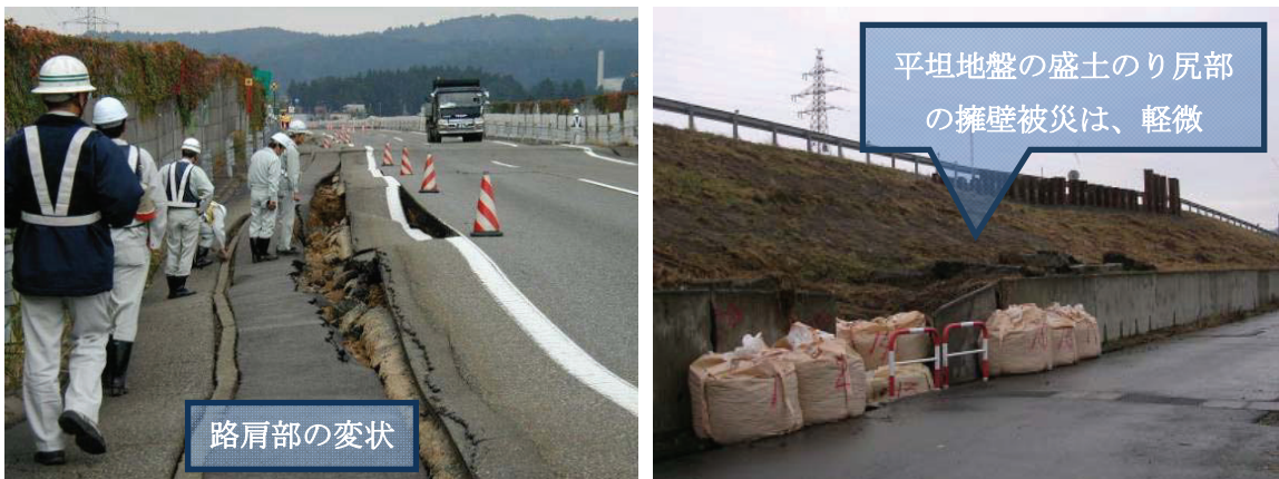
写真 2.6 平坦地盤の路肩部と盛土のり尻部の被災状況（新潟県中越地震）
