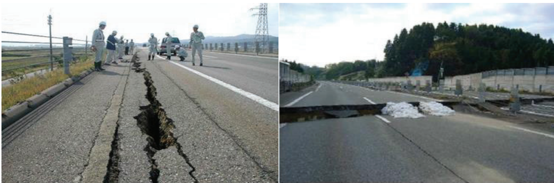
写真 2.3 構造物の段差や路肩部のクラック
