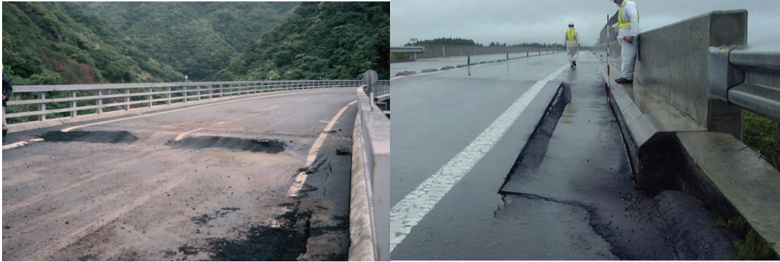
写真 2.2 道路の沈下（左：橋台裏込め部の沈下 右：橋台取付け部の路肩沈下）
