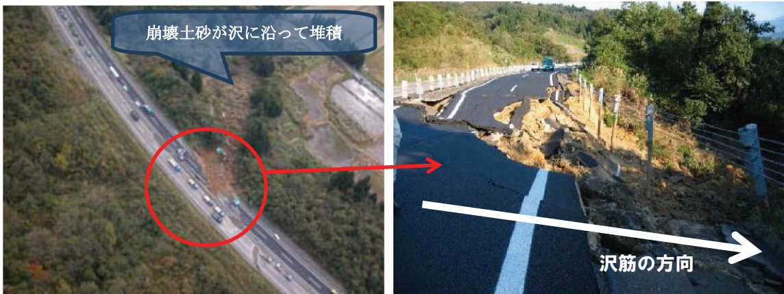
写真 2.5 沢部の盛土部被災状況（新潟県中越地震）
