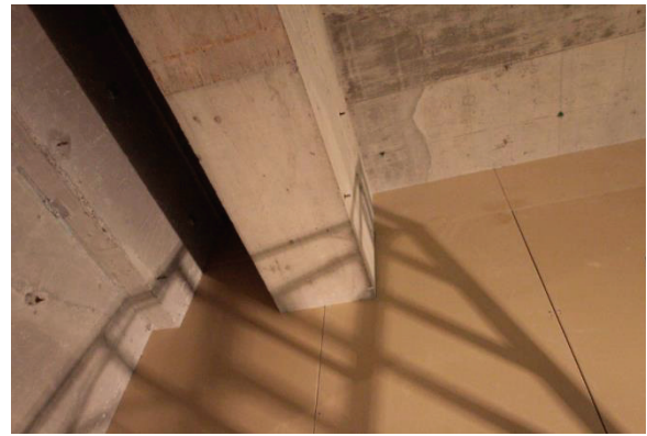
写真 4.17 梁周辺のせっこうボードの状況
