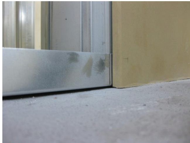
写真 4.14 床の凹凸により生じたランナーと床の間の隙間と床の形状に合わせて加工したため隙間なく取りつくせこうボード
