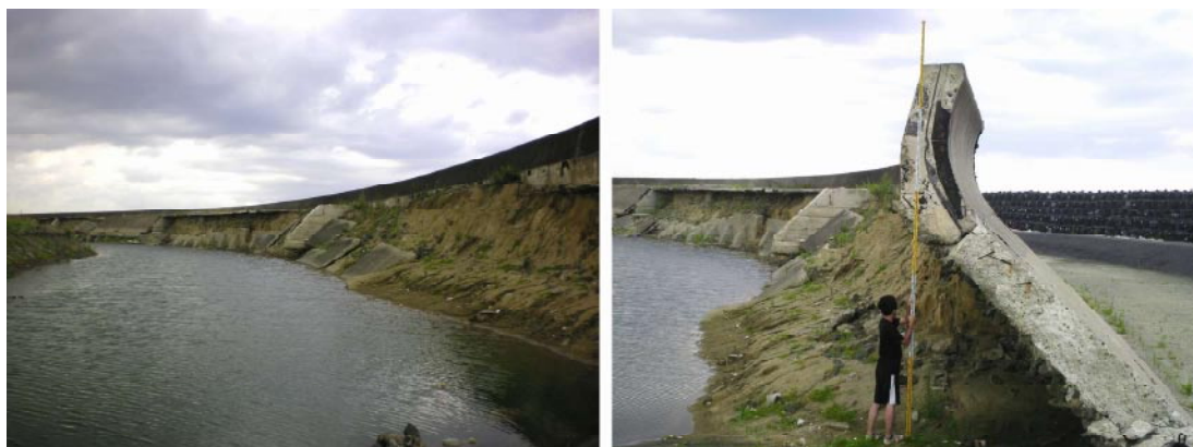
図-4.8 亘理町荒浜における海岸堤防被害の状況(落堀と残存した表法面)
