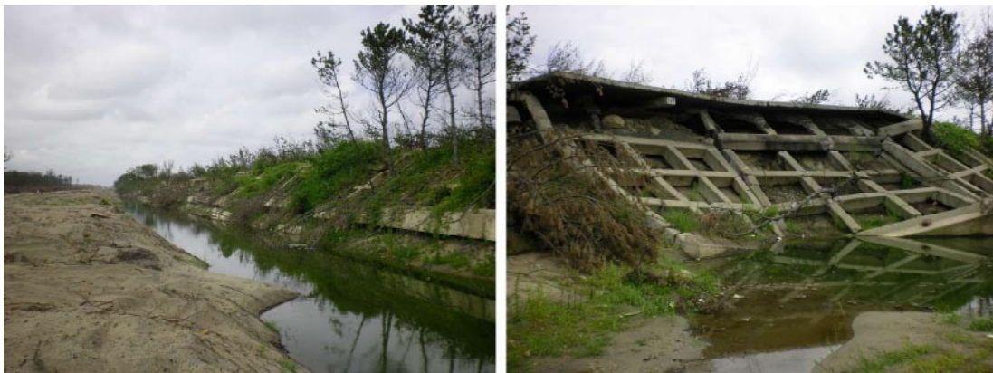
図-4.6 岩沼市寺島における海岸堤防被害の状況(落堀と裏法崩落部)
