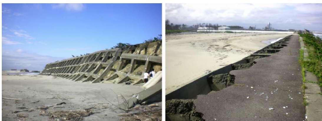
図-4.9 山元町高瀬における海岸堤防被害の状況(堤防の残存部と天端部の被害)
