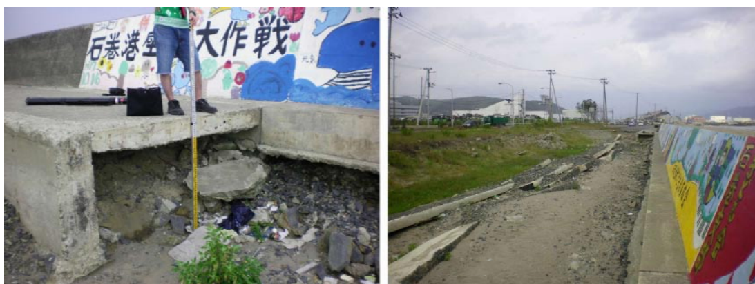
図-4.2 石巻市雲雀野町における海岸堤防被害の状況(背後の吸い出しと洗掘)
