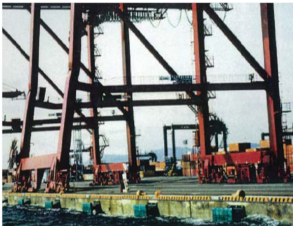
写真 3.1 クレーン脚損傷と脱輪の事例 (六甲アイランド)
