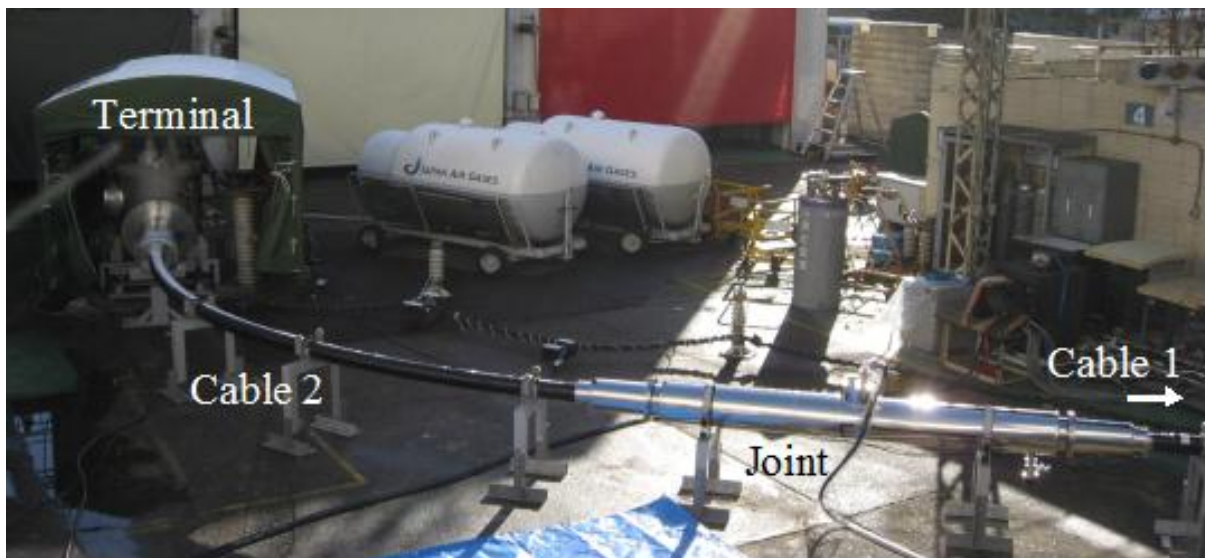
図 3.21 20 m 級 REBCO 超電導モデルケーブルの設置完成図
