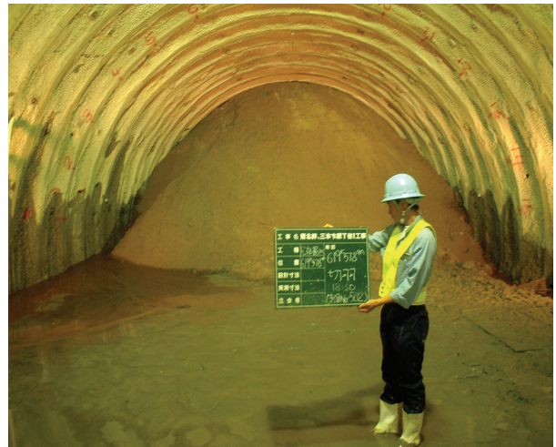
写真-2.2 平成14年9月の切羽の崩壊状況
