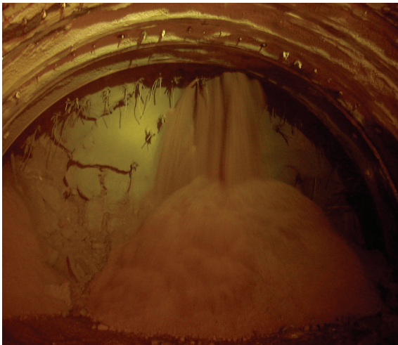
写真-2.1 平成14年3月の切羽の崩壊状況
