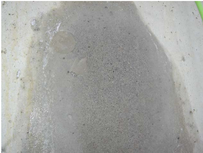
写真 3.2.5 北向きの側面における水の凍結状況
