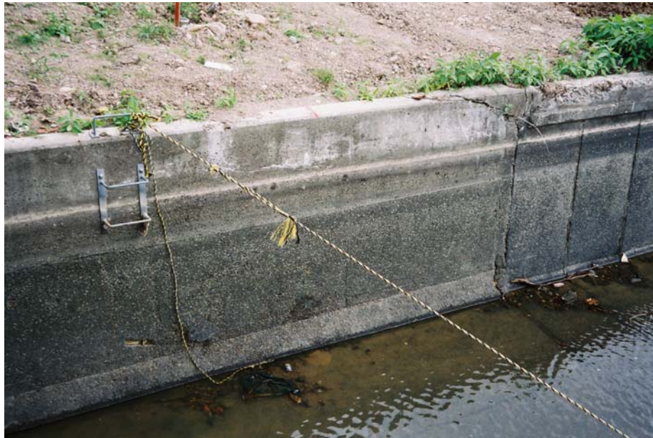
写真 3.2.2 用水路側面のスケーリング，ひび割れおよび剥落の状況の一例
