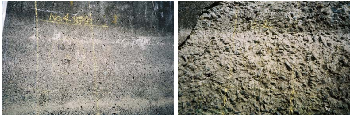
(d) No.4 (左：健全部，右：劣化部)
