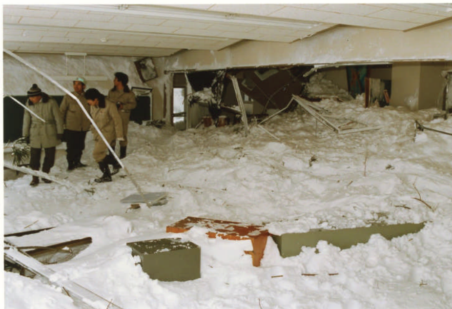
写真（補）－2 雪崩が直撃した中学校の教室（檜枝岐村所蔵）
