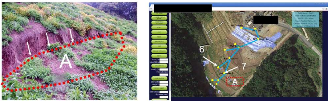
図 4.50: エリア 4 小規模表層崩壊の観測
