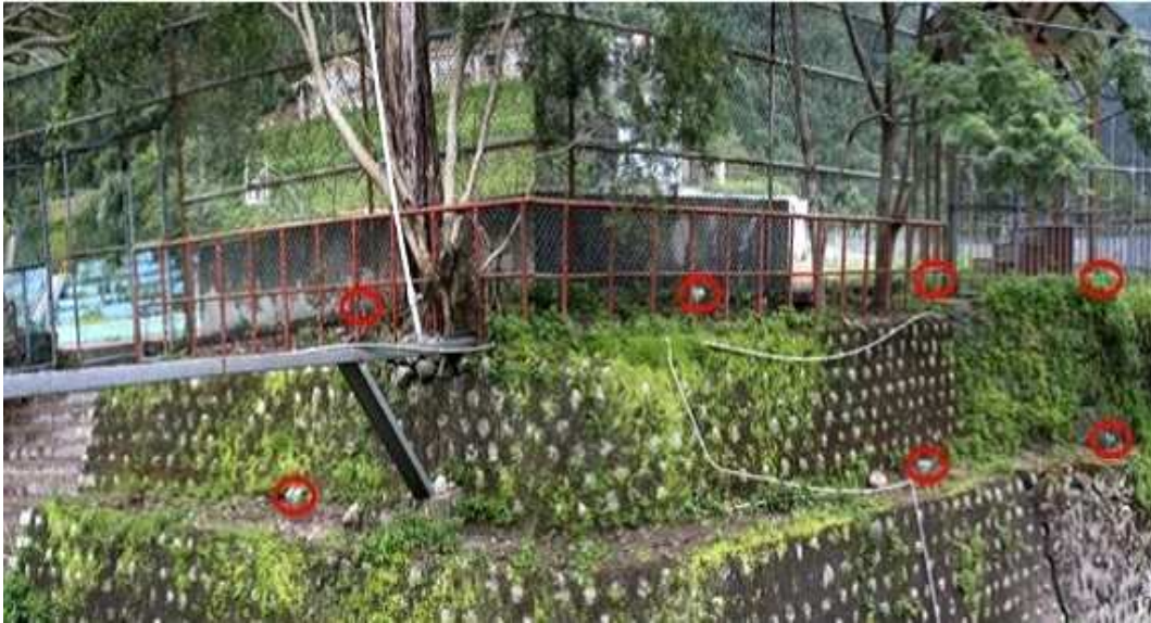
図 4.3: エリア 3 : 台湾尖石郷老朽化した石垣面
