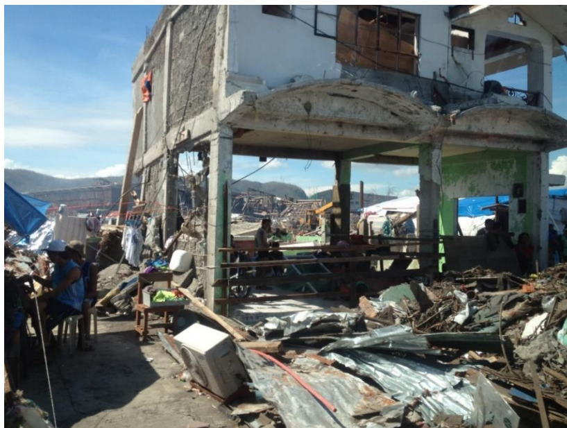
写真-2.4 タクロバンにおける建造物の損壊 (中村ら, 2014)
