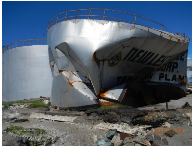
写真-2.3 Tanauan におけるココナッツオイルタンクの損壊 (Takagi et al., 2015b).
