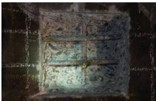
写真 3-2-5 鉄筋腐食状況 (1)
