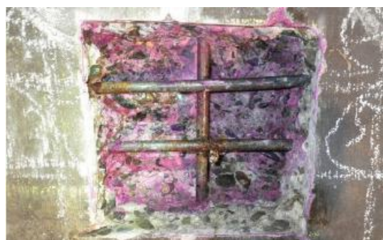
写真 3-2-4 中性化深さ状況
