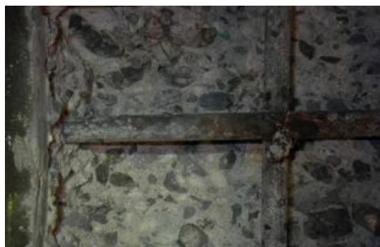
写真 3-2-5 鉄筋腐食状況 (2) (拡大)
