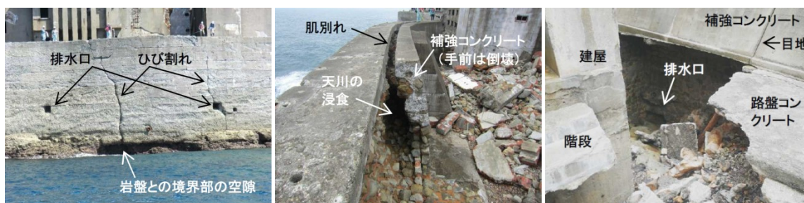
図-2.5 護岸の変状
