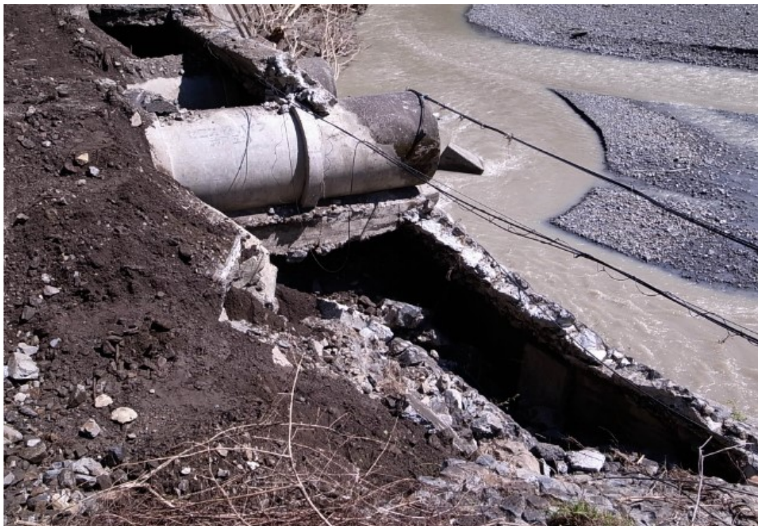
図 1.9 災害によって露出した地下埋設管 (2011.9 茂木撮影)
