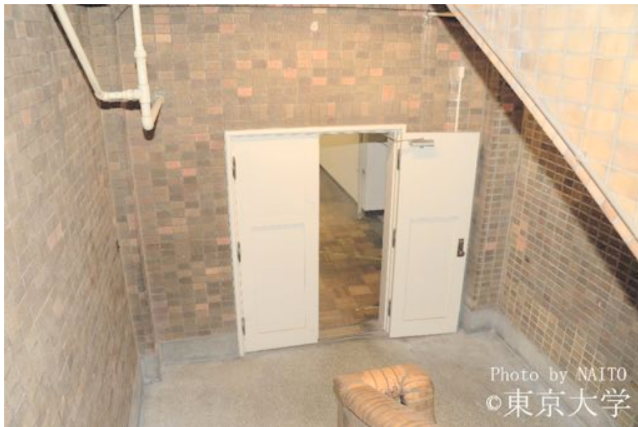
写真 37 東京大学医学部附属病院渡り廊下内壁
