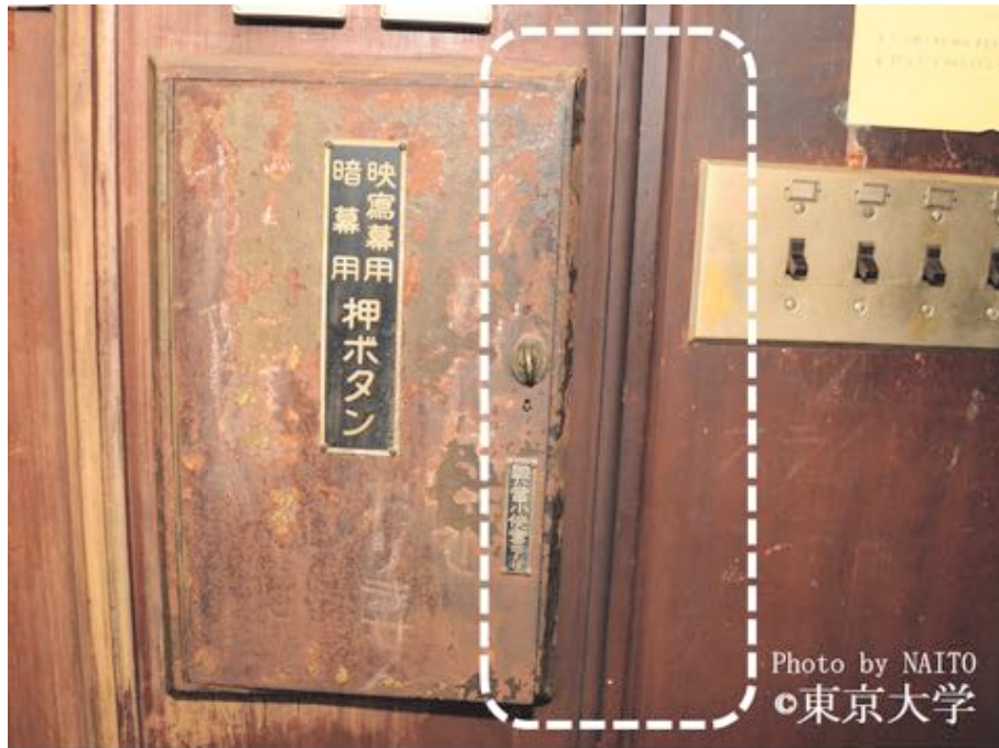
写真 27 東京大学医学部附属病院内科研究棟内科講堂スクリーン制御盤
