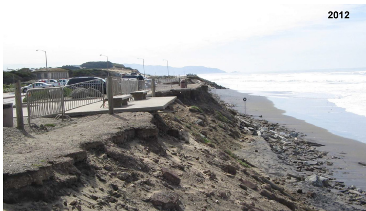
写真4-9 敷地南部 (SF ZOO付近) の海岸浸食被害の様子 Source : SPUR
