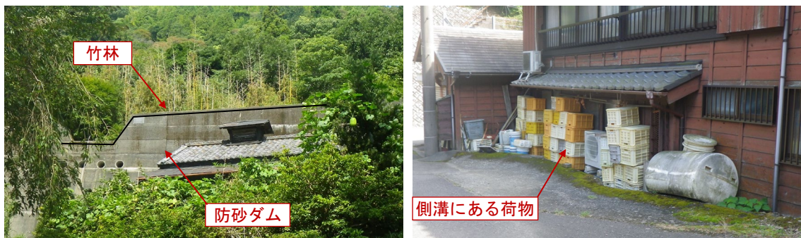
写真 2.4.1 (a) 防砂ダムに土砂と竹林の進入 ; (b) 側溝にある荷物と雑貨の堆積
