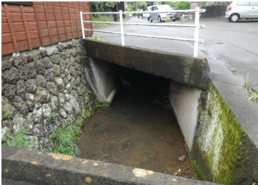
写真 2.3.3 道路拡張による川の急減部
