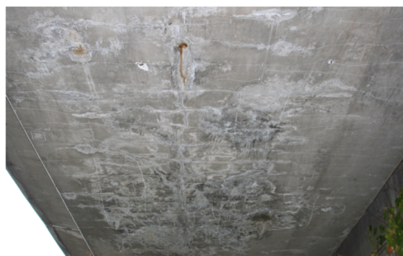
写真-1.1 実橋の床版下面のひび割れ
