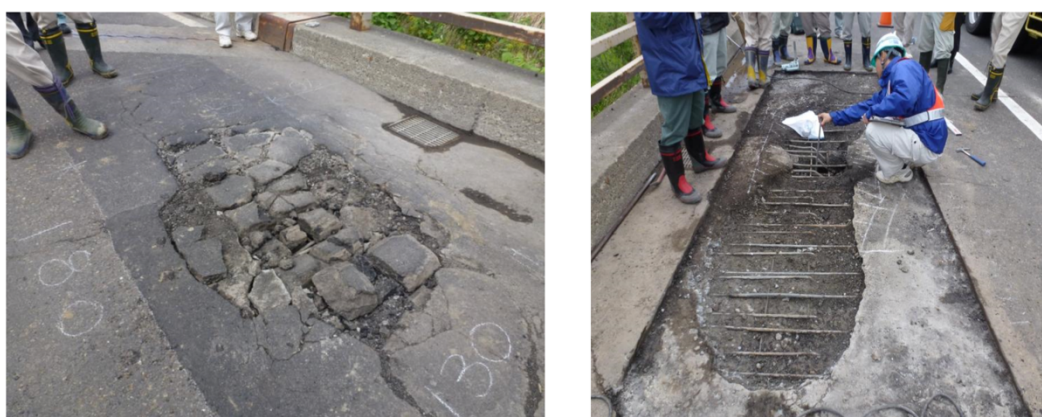
写真-1.2 RC床版の抜け落ちの事例 1-2)
