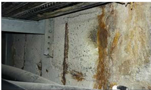
(a) 塩害による腐食状況
