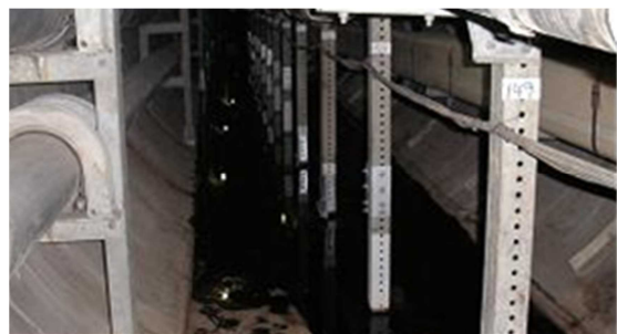
(b) トンネル内漏水状況
