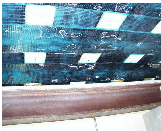
図2.1.1 打音検査で検出されたCFRPシートの浮き・膨れの例
