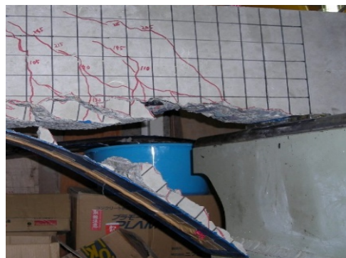
図 2.3.13 FRP スtrandシート 端部のかぶりコンクリートの破壊状況
