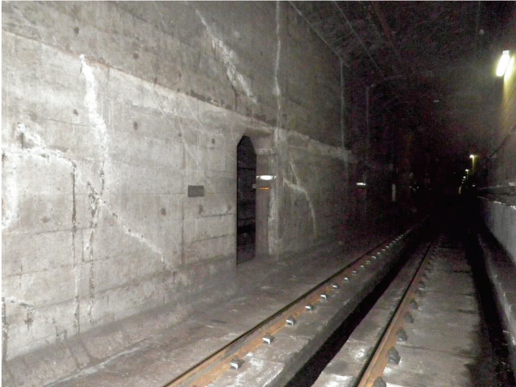
写真 4-1-2 近接施工の影響によるトンネルの変状（日比谷線 中壁のひび割れ）
