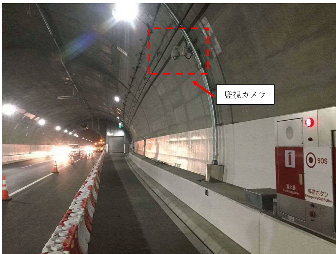
写真 3.4.6-6 本線トンネル内における監視カメラの設置状況
