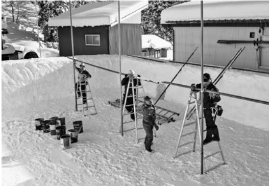
図6 運び出しが終わる前から単管パイプの組み上げ を始める (2018年2月14日, 筆者撮影)
