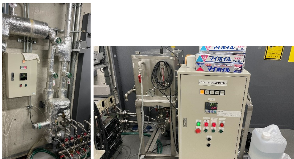
図 2.19 (左)熱交換器の外観、(右)タンクと循環水温度制御盤
